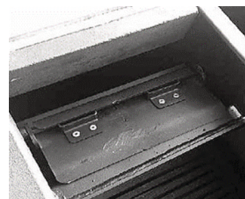
odprt usmerjevalec dima (17) ⇒ učinak kotla je značajno smanjen
